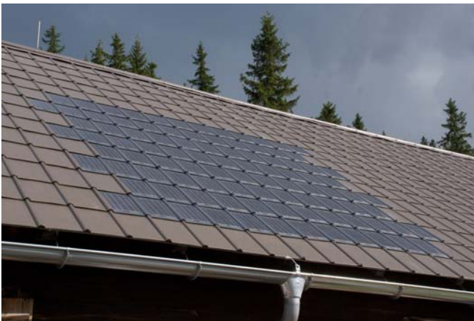
Auf der Schoberalm, eine Galtviehalm in Puchberg am Schneeberg (Niederösterreich), erfolgt die Stromversorgung mit Solarzellen.
