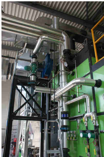
Feuerung, Kessel und Hydraulik
