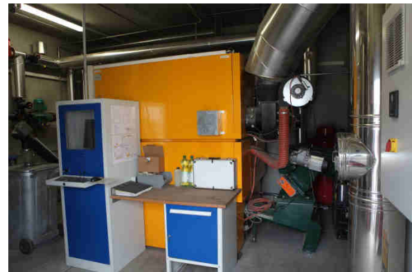
Feuerung und Kessel mit Schaltwarte
