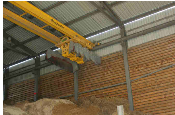
Kran zur Brennstoffbeschickung
