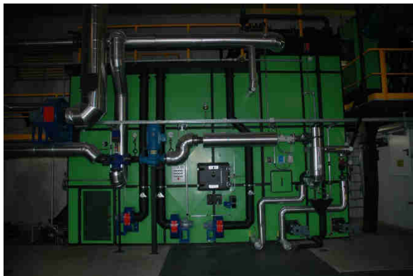
Feuerung und Kessel
