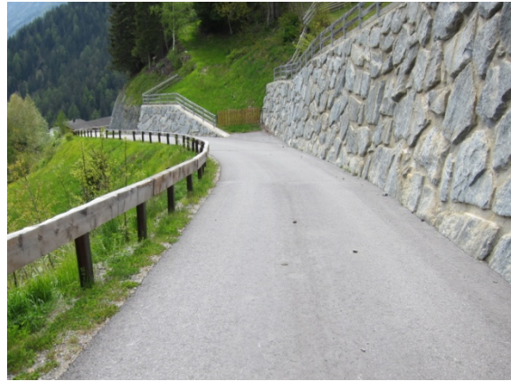
Leitschiene als Absturzsicherung in steiler Hanglage
