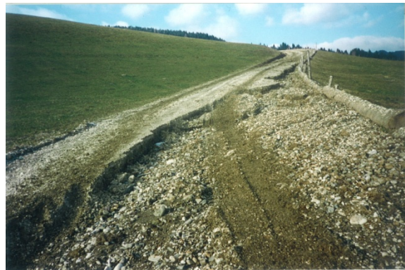
Vor Realisierung des Wegeprojektes: Zerstörter Schotterweg nach Starkregen (Foto: Besser)
