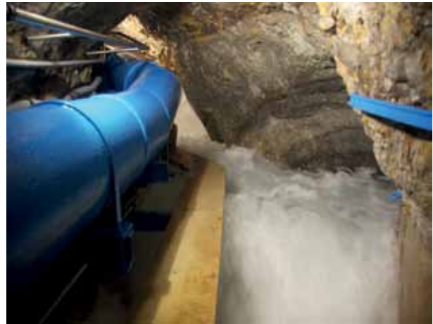
Im Hochschwabgebiet sind die Quellen- und Grundwasservorkommen der Trinkwasserversorgung gewidmet.
