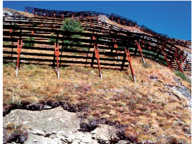
Lawinerverbauung in alpinem Gelände ist eine wichtige Maßnahme zur Vermeidung von Naturgefahren.
